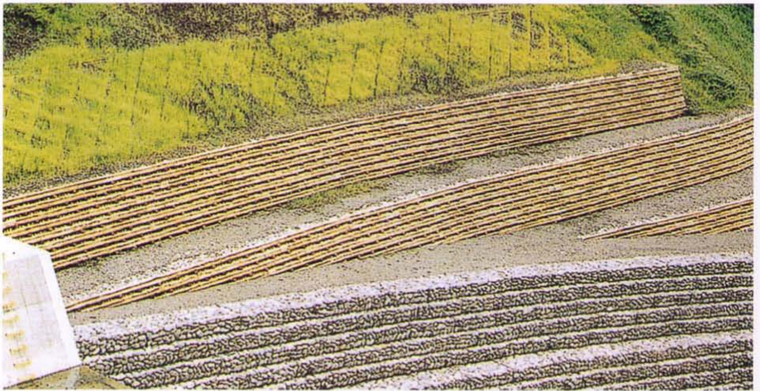
▲護岸工の上部に木製法枠工とウッドブロックによる土留山腹工（施工地／山梨県早川町）
