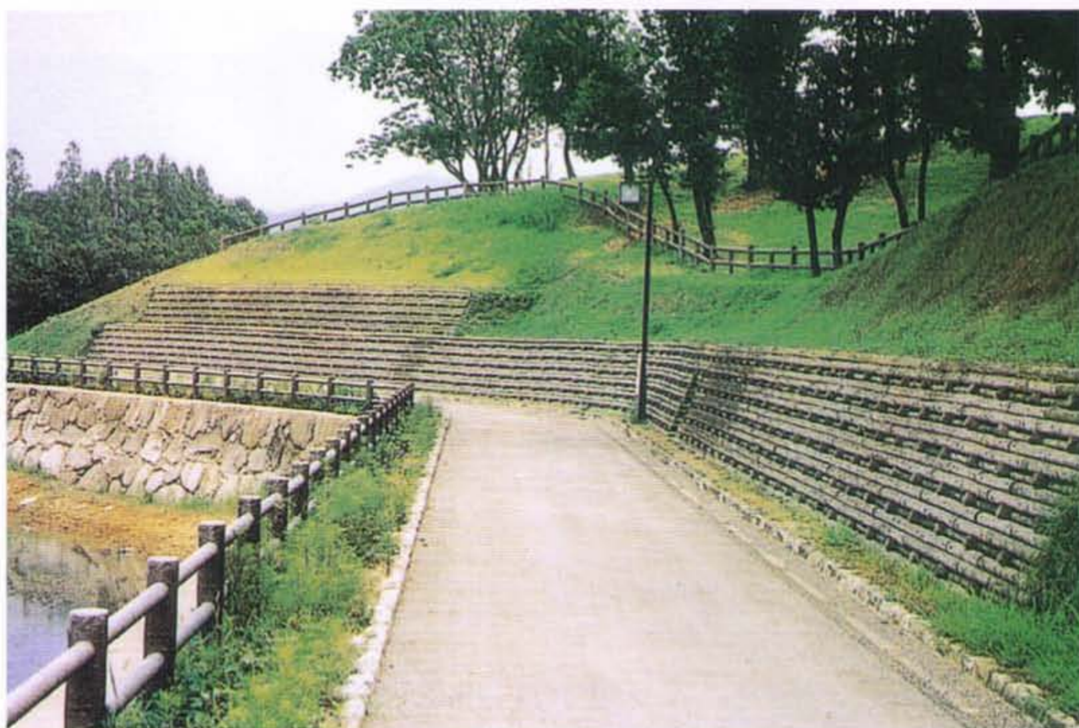
▲公園の土留工に使用したウッドブロック積（施工地／福岡県久留米市）
